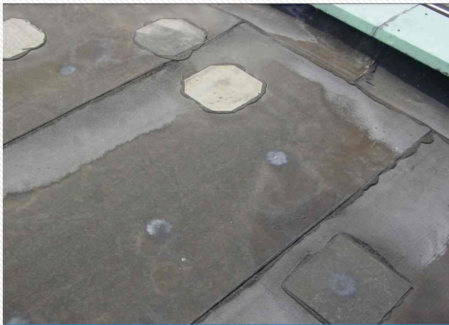
Рисунок 1: Пример поврежденной кровли
